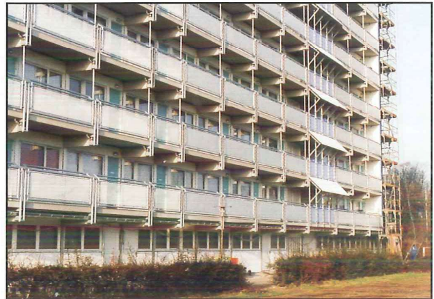
Varmforzinkede altanrækværker i højhusbyggeri.
