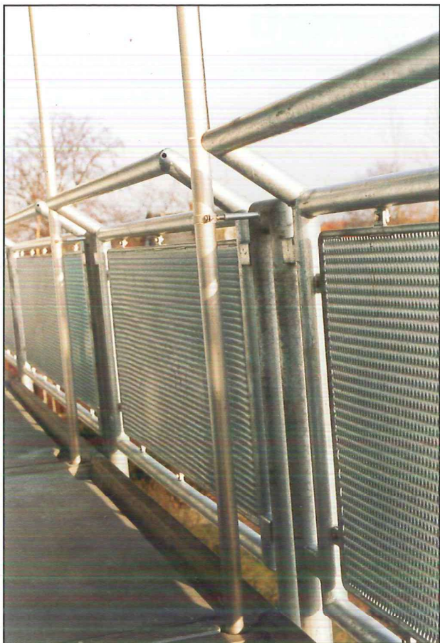
Varmforzinkede altanrækværker i højhusbyggeri.
